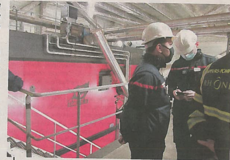
Chaudière à bois.
